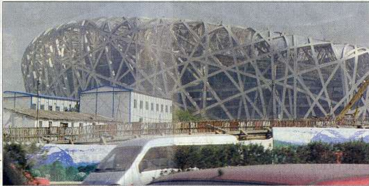
► En construction, le stade olympique, surnommé "Le nid d'oiseau", d'une capacité de 91 000 places, dont 19 000 amovibles. Un monument de technologies novatrices qui pèse 45 000 tonnes d'acier et 3 milliards de yuans (294 millions €).
